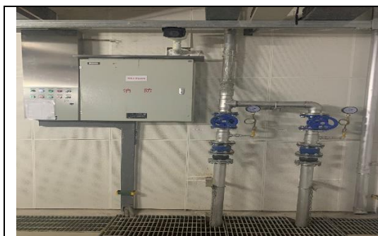
#1 主变同层南侧消防水泵照片
