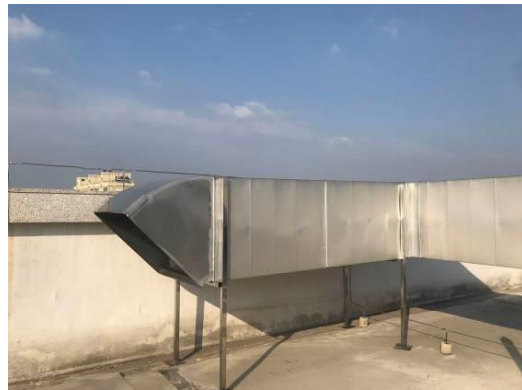
食堂油烟废气排口
