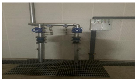
#2 主变同层北侧消防水泵照片
