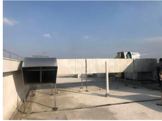
食堂油烟废气排口
